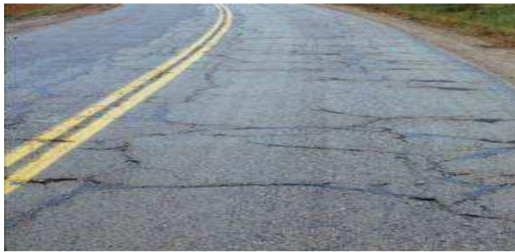
Gambar 2.10 Retak refleksi ( reflection crack )
