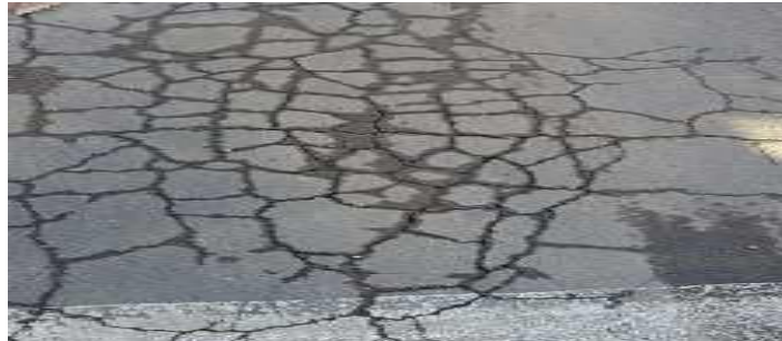
Gambar 2.6 Retak kulit buaya ( alligator crack )
