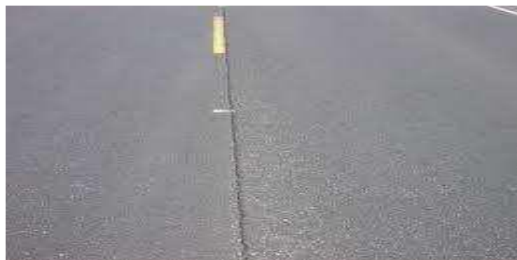
Gambar 2.8 Retak sambungan jalan ( lane joint crack )
