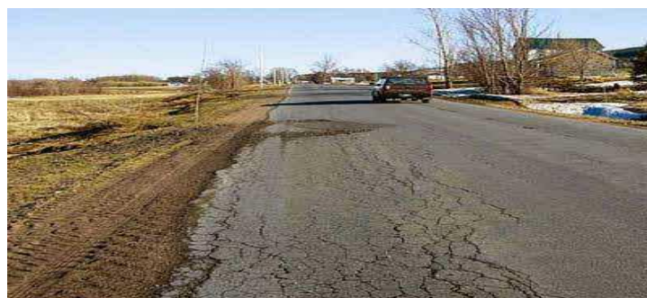
Gambar 2.7 Retak pinggir ( edge crack )
