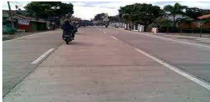
Gambar 2.9 Retak sambungan pelebaran jalan ( widening crack )
