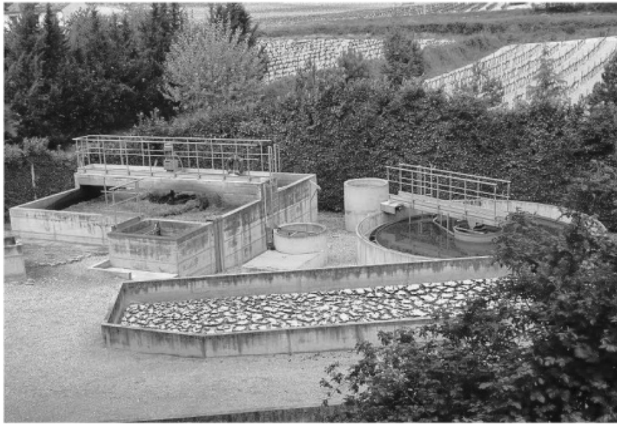
Gambar 2.1 Tanki Sedimentasi di Thailand.
