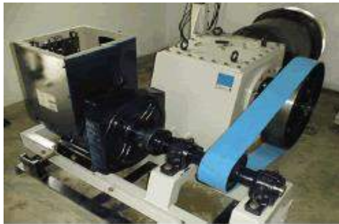
Gambar 14. Turbin dan generator
