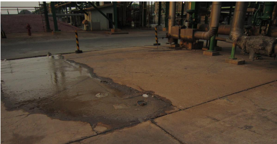
Gambar..... Rembesan fluida pada kawasan backwash dan jacket water
